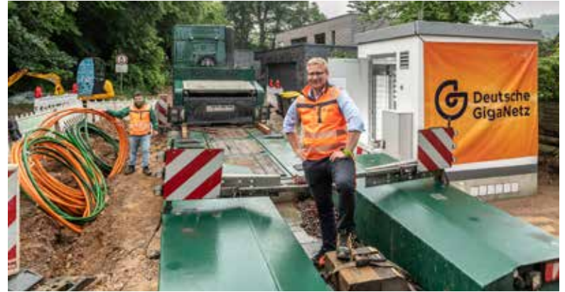
Aufstellung des PoP in Schlangenbad (v. l. n. r.): Georgios Tsatsaris (Bauüberwacher der Deutschen GigaNetz), Max Summa (Projektleiter Construction Management der Deutschen GigaNetz)
